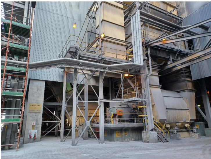
Figure 134: Lethabo ID fan Unit 1
